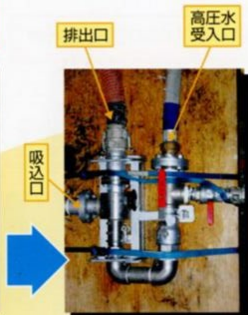
ろ材の吸上げポンプ
