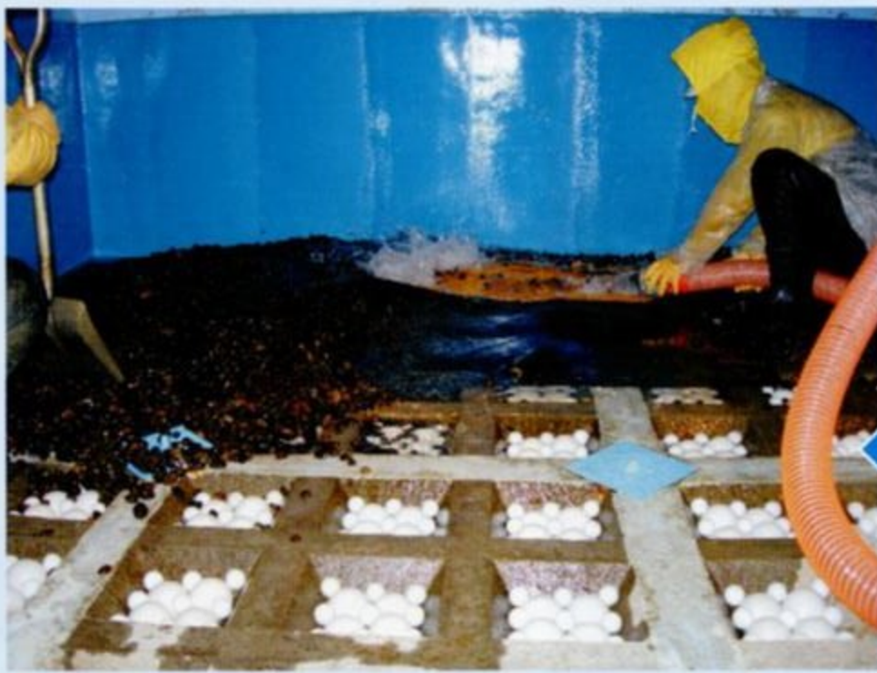
洗浄・選別されたるろ材のひきならし
